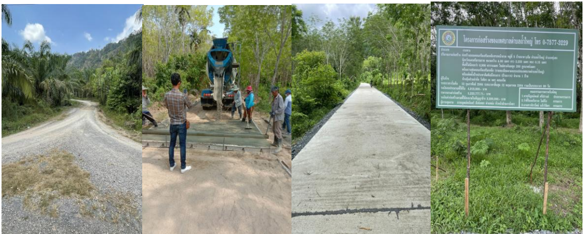
19. โครงการก่อสร้างถนนคอนกรีตเสริมเหล็กสายวังแห้ง หมู่ที่ 9 งบประมาณ 461,000 บาท
