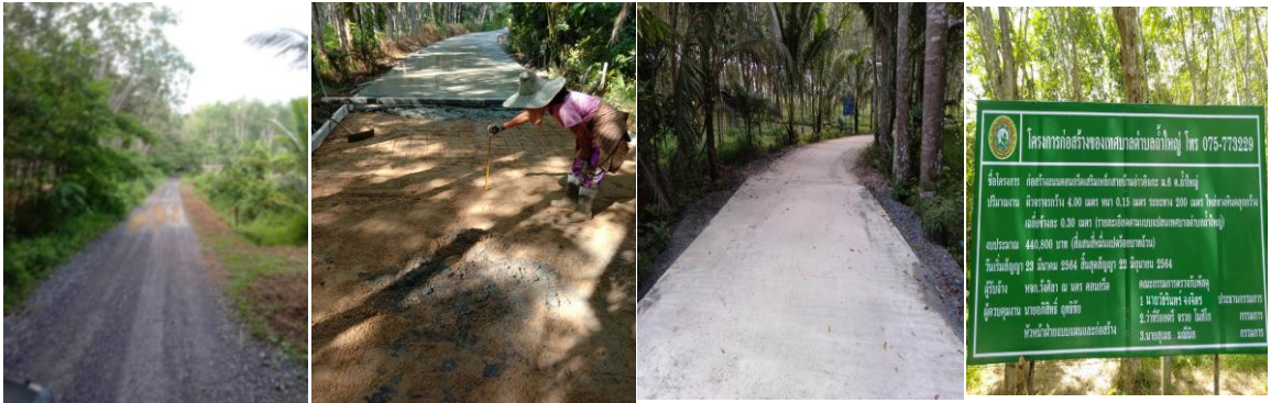
15. โครงการก่อสร้างถนนคอนกรีตเสริมเหล็กสายห้วยชัน หมู่ที่ 4 งบประมาณ 483,000 บาท
